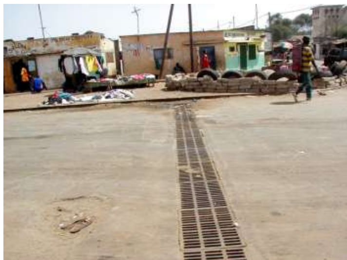
Malgré l'existence de système de canalisation l'assainissement de Cayar n'est pas encore effectif
