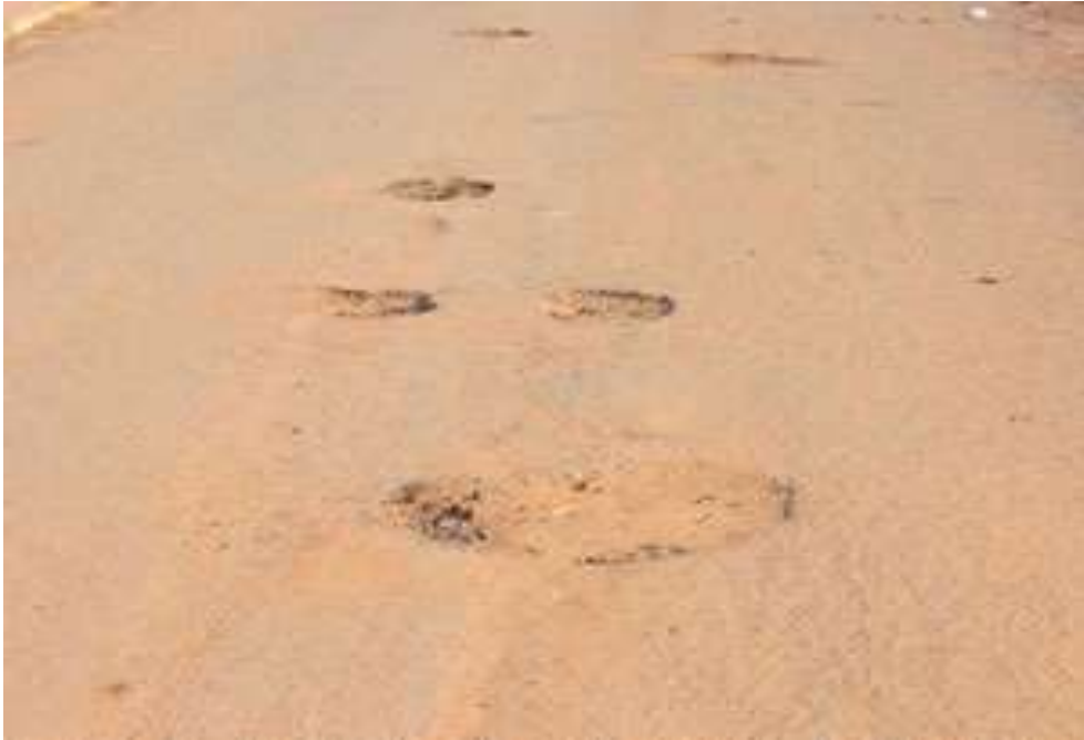
Photo 7 : Dégradation de la voirie avec les nids de poule.
