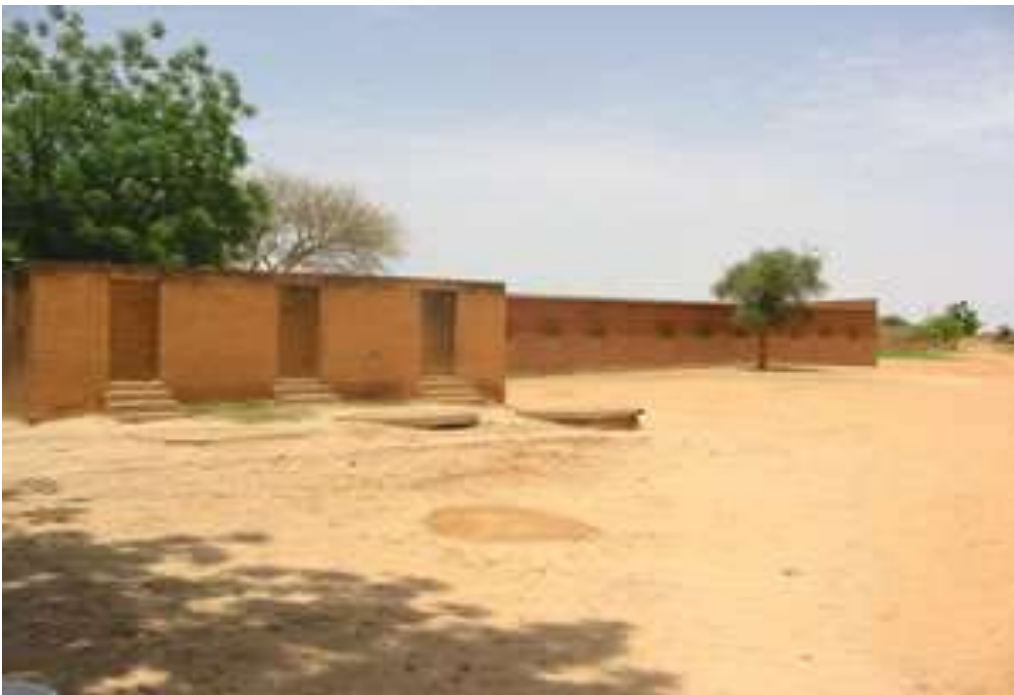
Photo 4 : Processus de dégradation au CEG II.
