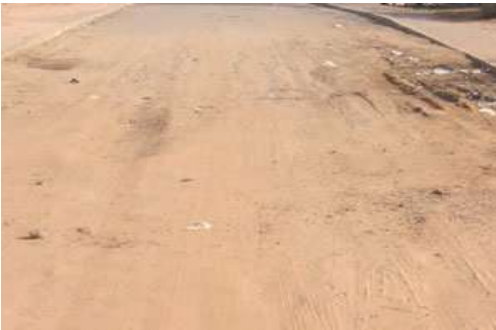
Photo 8 : Ensablement de la voirie occasionné par l'érosion.
