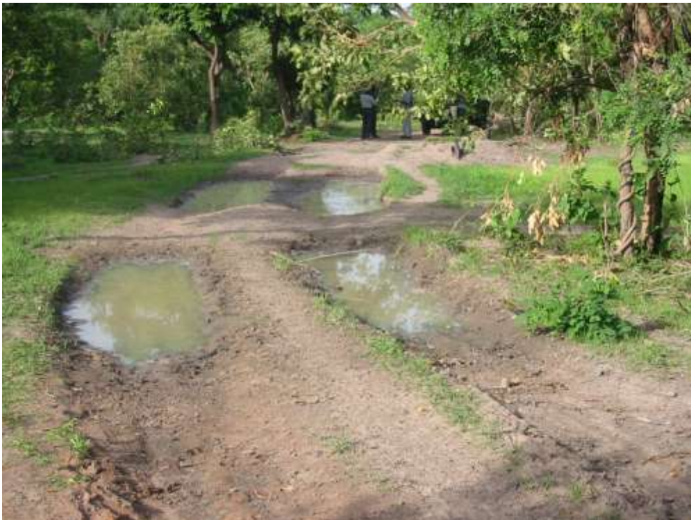
Photo 7 : Une des pistes de production de la Communauté rurale de Kounkané, difficilement praticables en saison des pluies.
