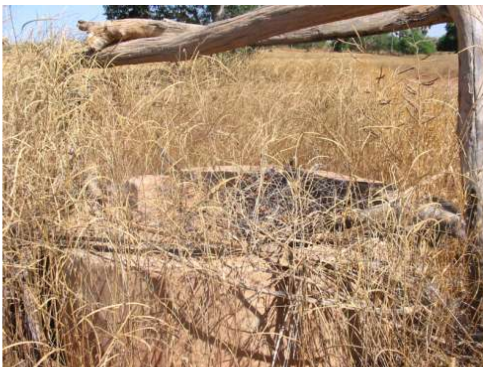
Photo 6 : Puits défectueux à Malem Niani
