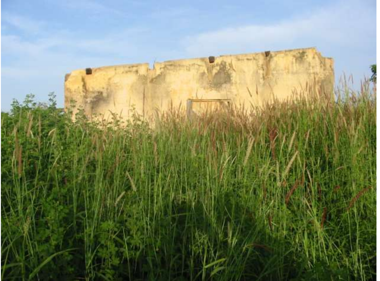
Photo n° 1 : L'état de dégradation de la case de santé du village de Médina Touat
